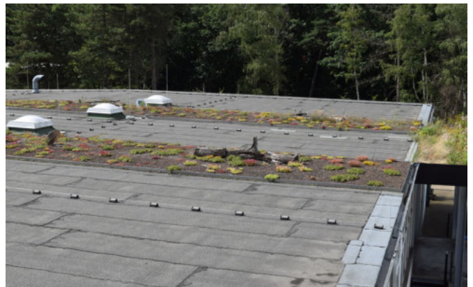
Abb. 63 Nachträgliche extensive Dachbegrünung bei der Fa. Reckhaus in Bielefeld: Das aufgebraachte Totholz wertet die Begrünungsstreifen ökologisch auf. (BuGG)
