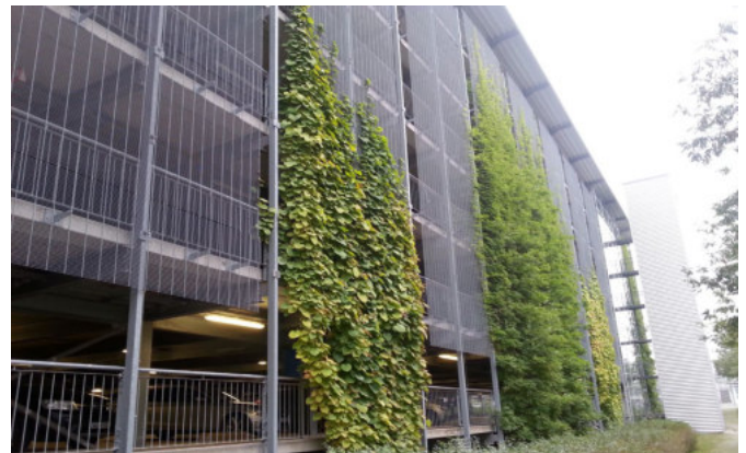
Abb. 65 Messeparkhaus München, wo Kletterhilfen in Form von Gittern installiert wurden, um die bodengebundene Fassadenbegrünung zu führen. (BuGG)
